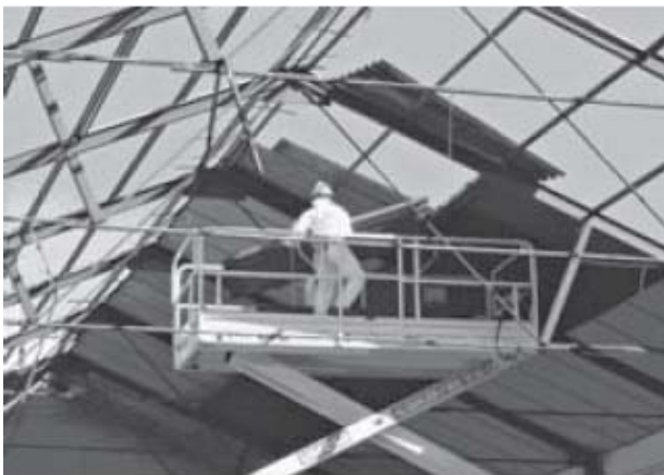
Figura 6 Placas de falso techo con contenido en amianto
